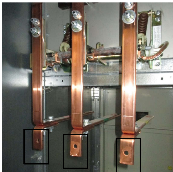
Рисунок 19 – Консервация контактных поверхностей токоведущих шин в отсеке кабельных присоединений
